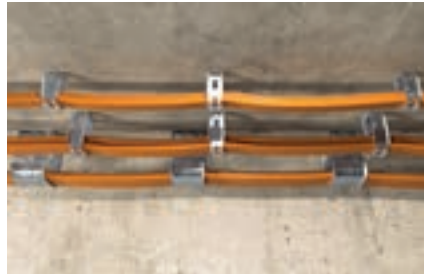
Kabelbefestigung an der Decke
