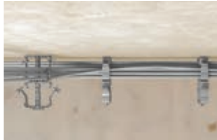
Befestigung von Kabelbündeln
