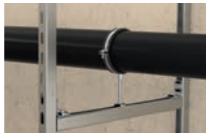
Rohrbefestigung auf Rahmenkonstruktion
