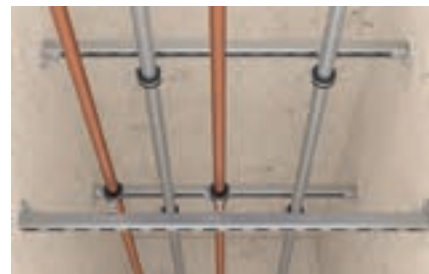
Rohrbefestigung im Flurbereich
