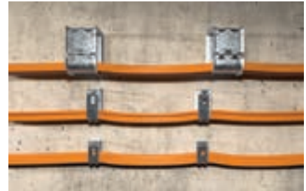
Kabelbefestigung an der Wand
